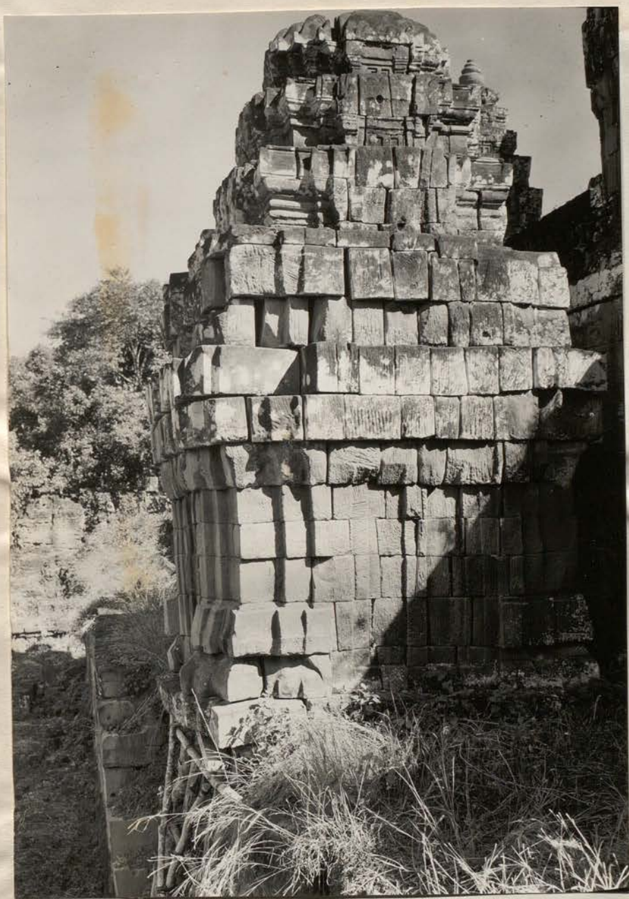
8517. Bakhang - 1 re Etage - Face W. Angle. S. W. Tour secondaire menacé par éboulement. 29 dec 59
