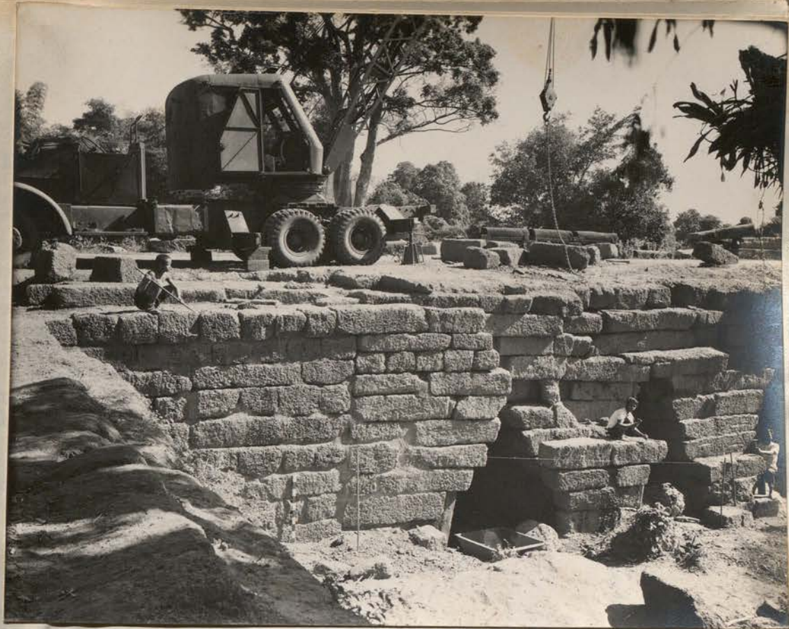
8296. 5 Janv. 57. Pont de Kompong Kdei. Riv. Sud. Début de la reprise à l'Ouest
