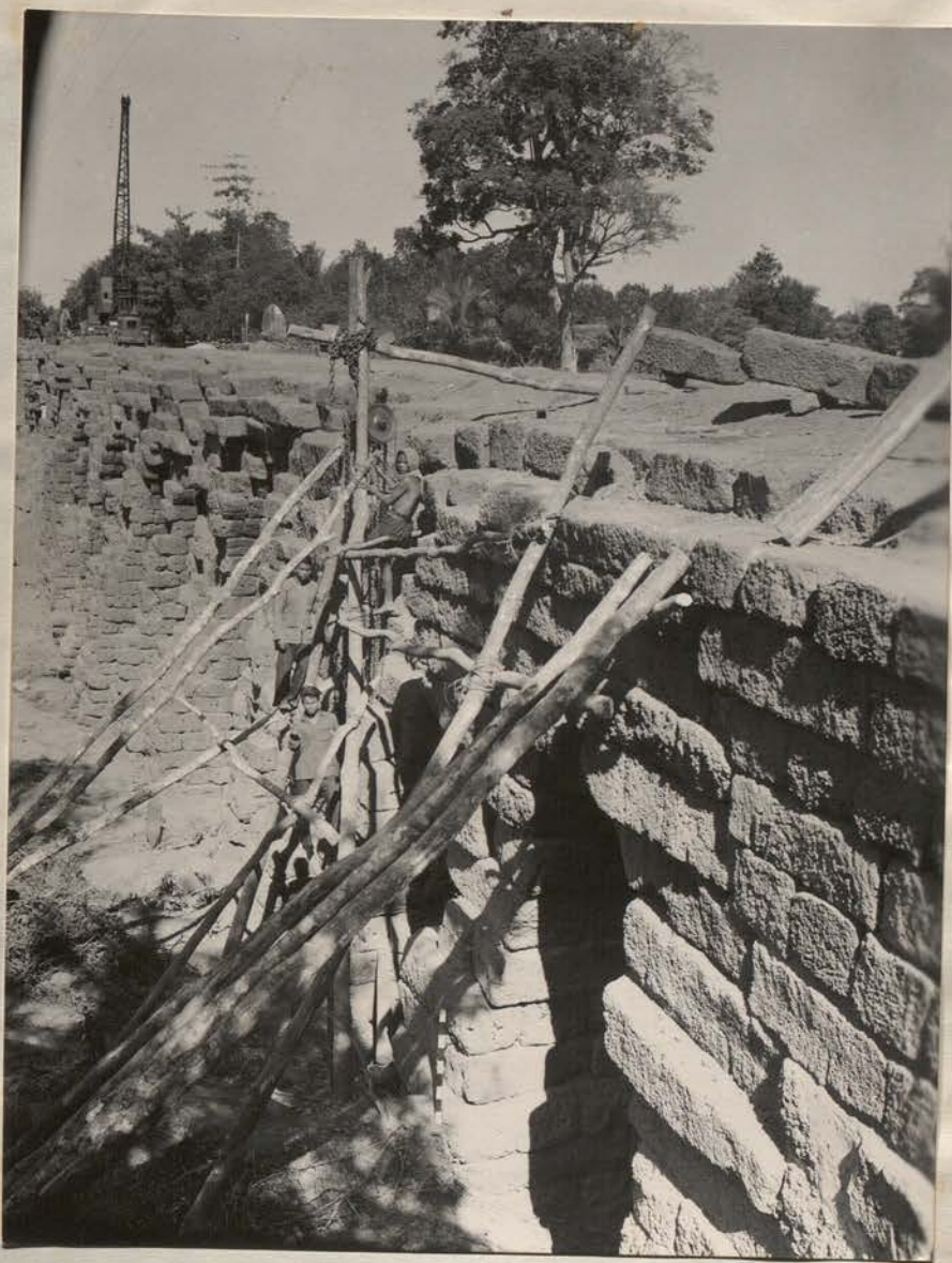
8294. 20 Janv 57. Pont de Kompong Kdei. Non sud - débüt de la reprise à l'extrémité E -
