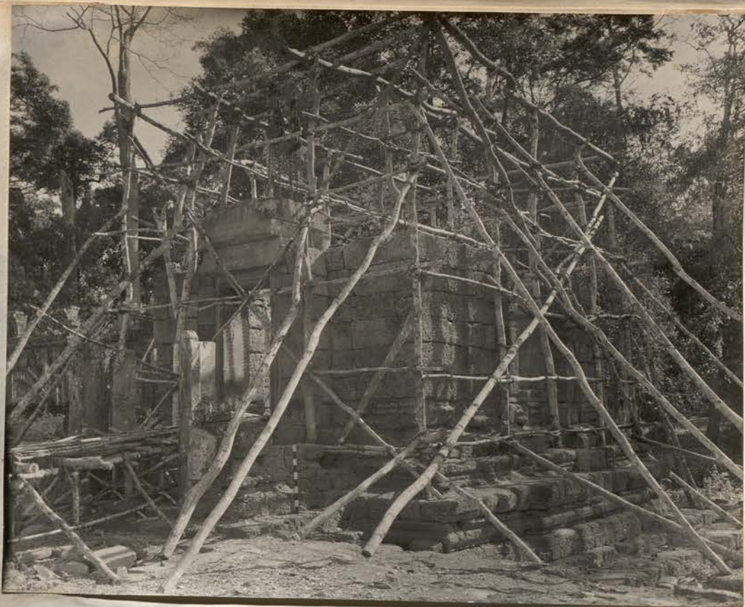
8351 - Février 58. Pa. Sua Prati n°4. Face Ouest - Linteau posé et Ferrures remontées.
